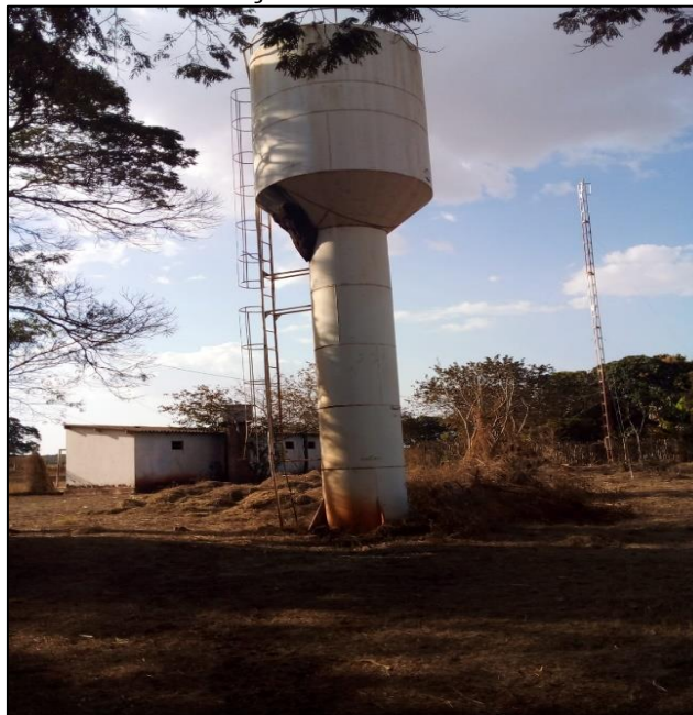
Figura 23 - Sistema de reservação no Distrito de Patrimônio dos Poncianos.
