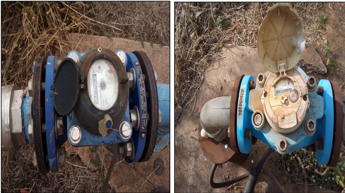
Figura 24 – Macromedidores instalados nos poços de captação.
