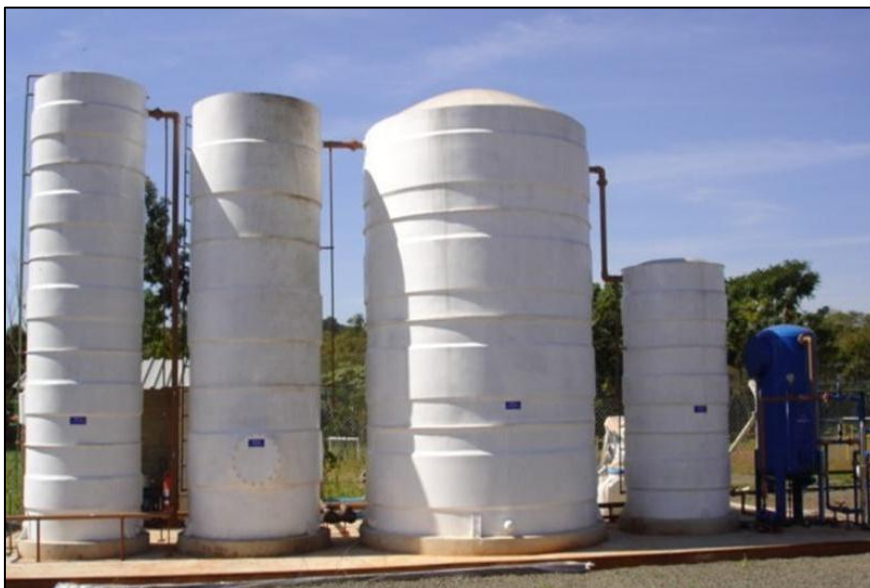
Figura 31 – Estação Compacta de Tratamento de Esgotos Sanitários.
