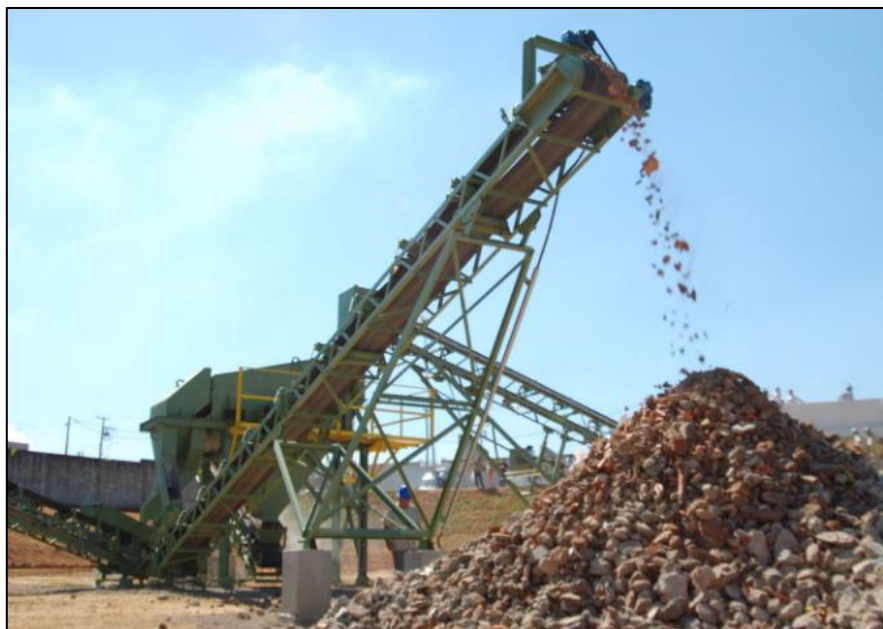
Figura 102 - Usina fixa de RCC.
