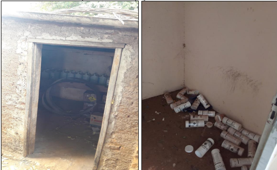
Figura 20 - Locais para o armazenamento dos produtos utilizados no tratamento da água proveniente dos poços subterrâneos.
