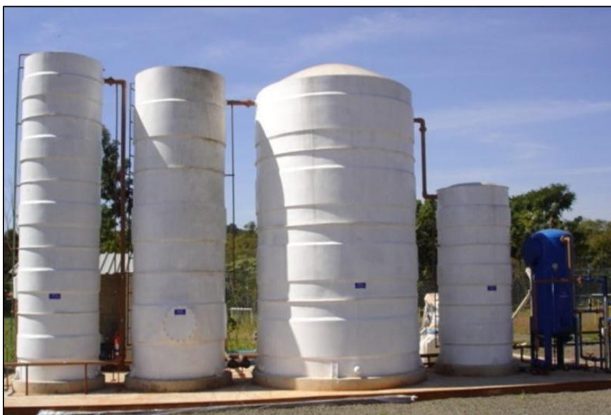
Figura 75 – Estação Compacta de Tratamento de Esgotos Sanitários.
