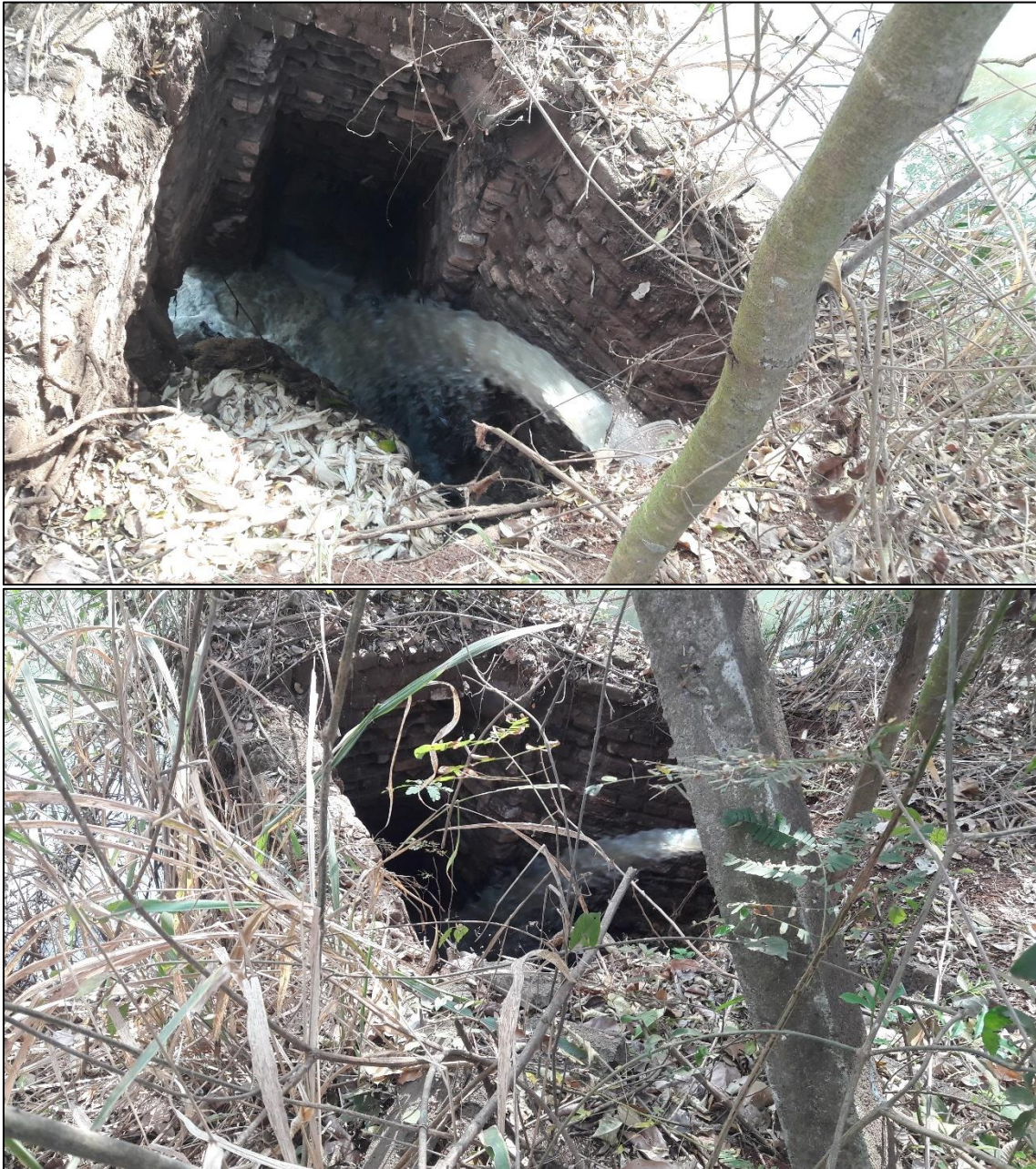
Figura 26 - Disposição de esgotos domésticos diretamente no rio.
