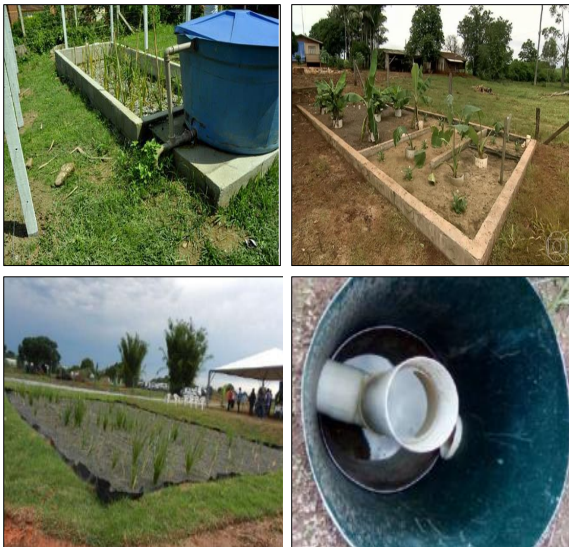
Figura 79 - Exemplos de zonas de raízes e mecanismos de controle de PVC.
