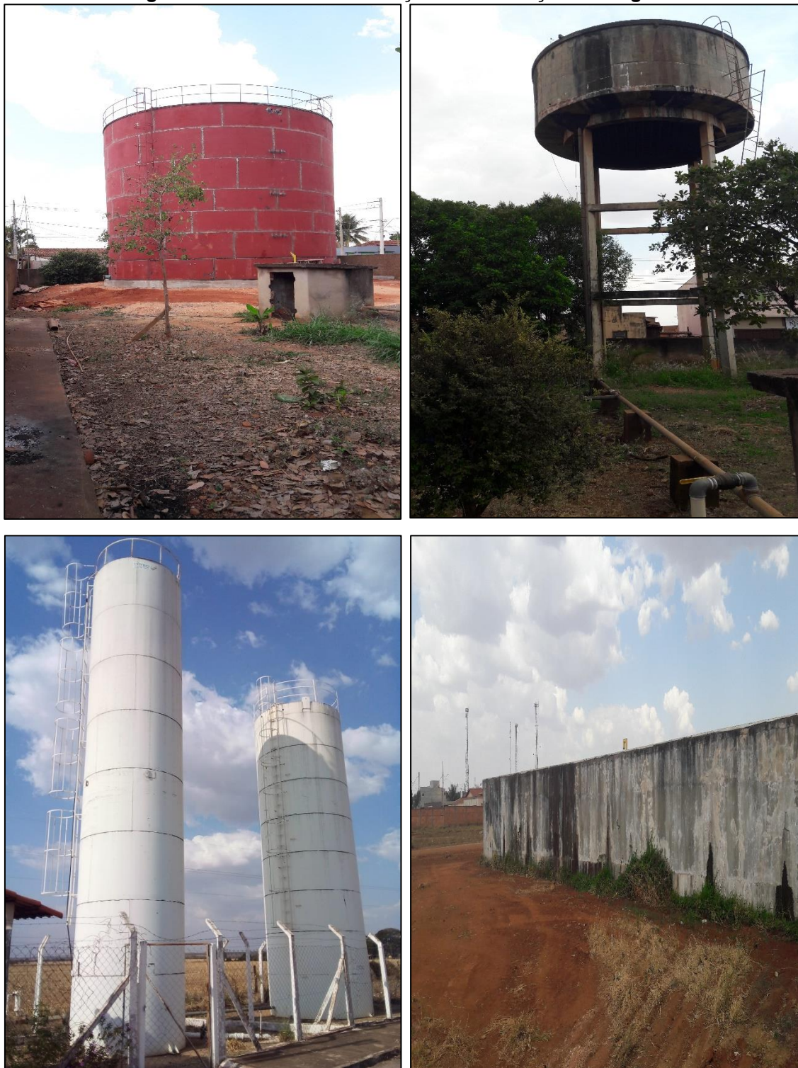
Figura 22 - Sistema de reservação em Conceição da Alagoas.
